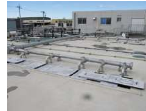
関東工場で増強した排水設備
